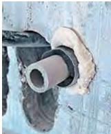
Магистральная полипропиленовая труба при вводе в коттедж, пропущена через отрезок жёсткой ПВХ-трубы большего диаметра.
