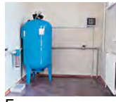
Гидроаккумуляторный бак удобно расположить в тёплом подсобном помещении, подвале или на цокольном этаже дома.
