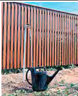
Один из кранов сезонной ветви водопровода для подключения системы полива.
